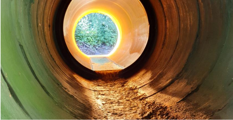
Figur 9 Feillagt kulvert etter veiarbeid i Kilsbakken
