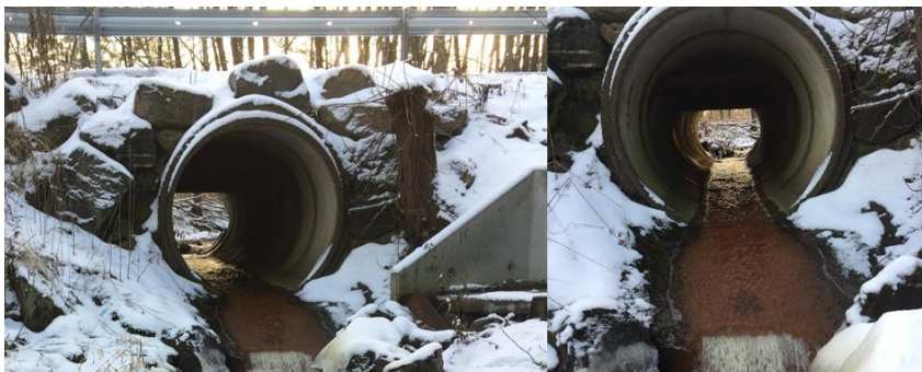
Figur 8. Kulvert under Kilsbakken utgjør et vandringshinder. Foto: COWI AS.
