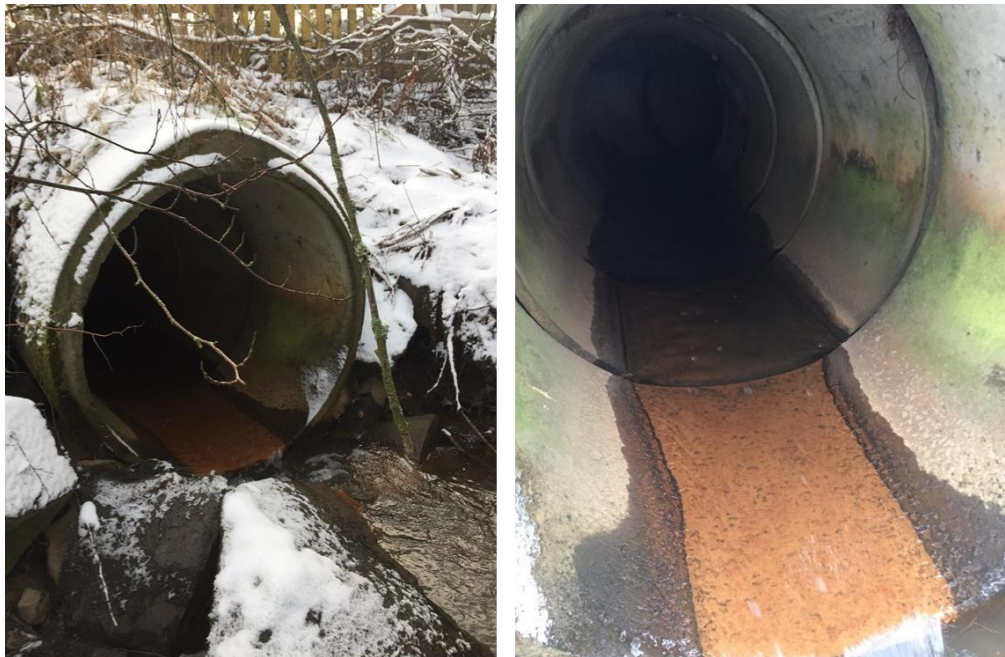
Figur 13. Kulvert under Oslovegen utgjør et vandringshinder Foto: COWI AS
